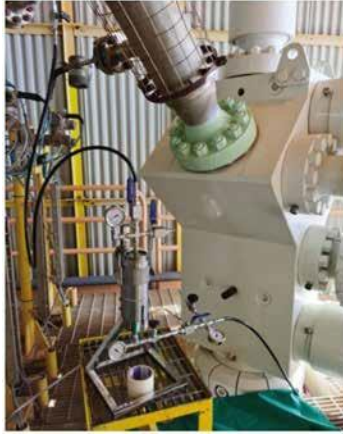
Abbildung 5 - Einrichtung eines Online-Sandprobennehmers (OSS) im Bohrlochkopfbereich (stromaufwärts des Bohrlochkopf-Desanders) zur Entnahme physischer Sandproben aus der Fließleitung durch Anschluss an die Probenahmestelle.
